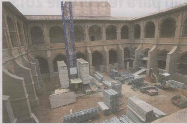
Estado actual que presenta el claustro de Fitero. Al fondo a la derecha, zona donde se están reconstruyendo las bóvedas hundidas.
